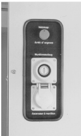
Figur 21 - Schalter des Munitionsaufzuges (Richtraum)
